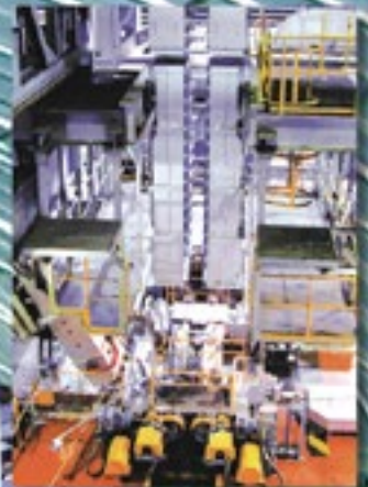
脱問工場めっき設備
